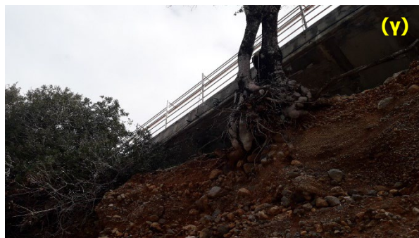
Εικόνα 1-4: (α) Άποψη καταπτώσεων και εκτεθειμένου πρανούς στην περιοχή μελέτης, (β) Άποψη σπηλαιώσεων του πόδα του πρανούς, (γ) Άποψη διαβρωμένου τμήματος πρανούς
