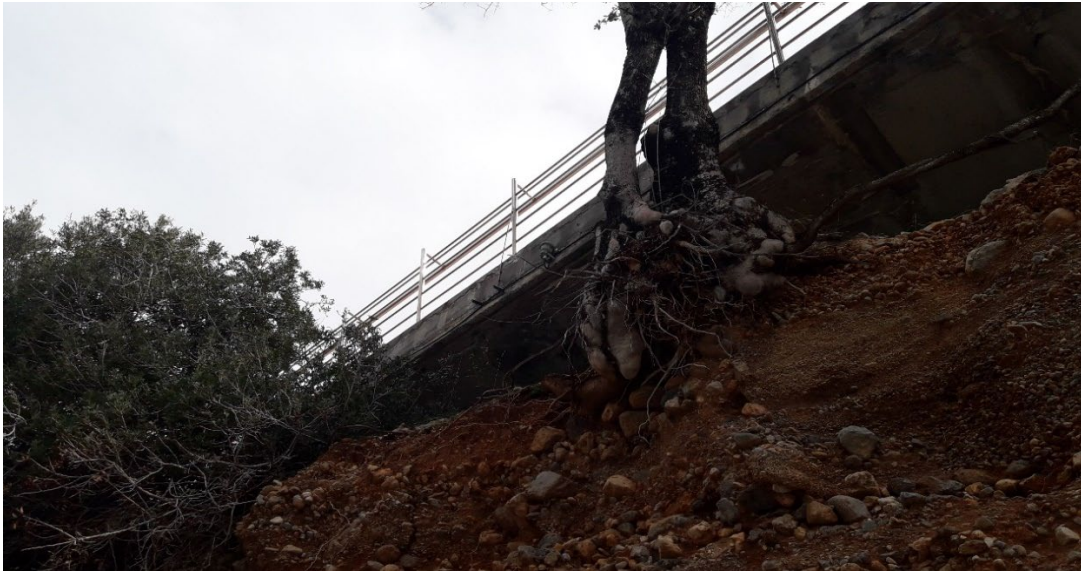
Εικόνα 3-4: Άποψη διαβρωμένου τμήματος πρανούς
