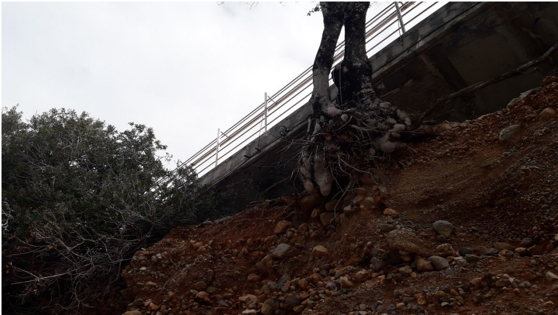
Εικόνα 8-6: Άποψη διαβρωμένου τμήματος πρανούς
