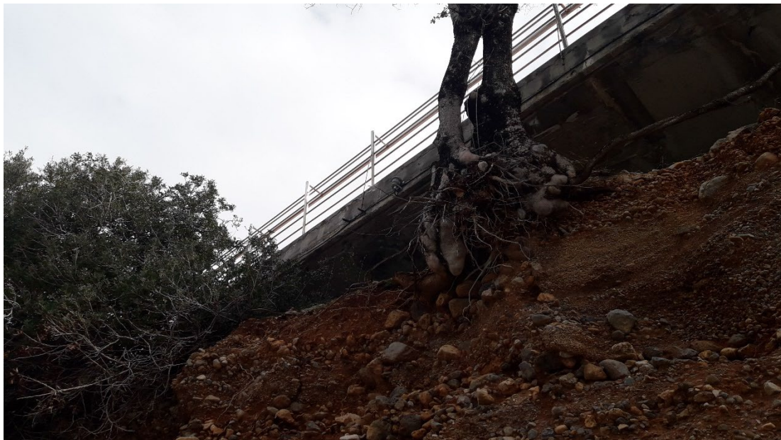
Εικόνα 6-7: Άποψη διαβρωμένου τμήματος πρανούς
