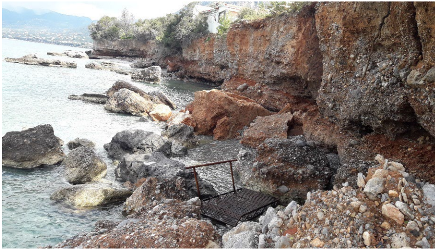
Εικόνα 8-4: Άποψη καταπτώσεων και εκτεθειμένου πρανούς στην περιοχή μελέτης
