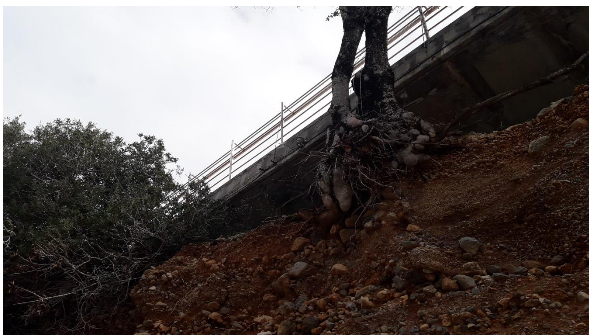
Εικόνα 10: Άποψη διαβρωμένου τμήματος πρανούς
