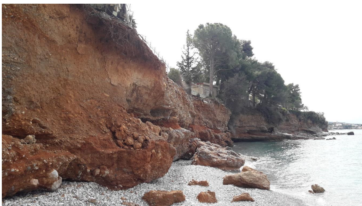
Εικόνα 12: Άποψη διαβρωμένου τμήματος πρανούς
