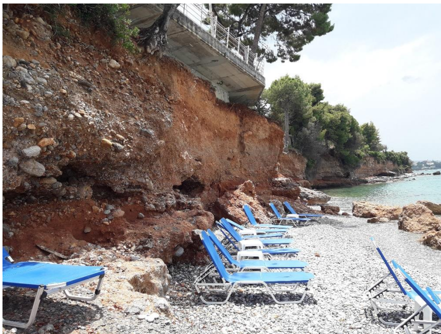
Εικόνα 11: Άποψη διαβρωμένου τμήματος πρανούς
