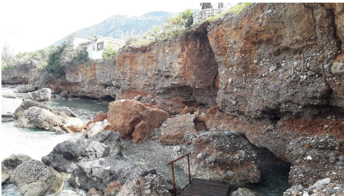
Εικόνα 9: Άποψη σπηλαιώσεων του ποδός του πρανούς
