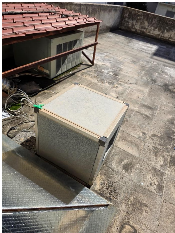
Εικόνα 15. Σύστημα μηχανικού αερισμού
