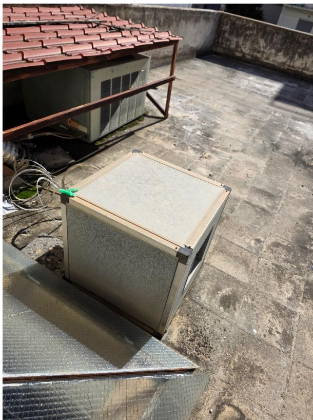
Εικόνα 15. Σύστημα μηχανικού αερισμού
